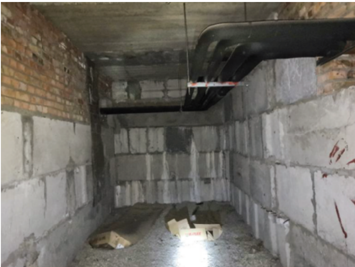
Техническое состояние подвала дома 2-1
