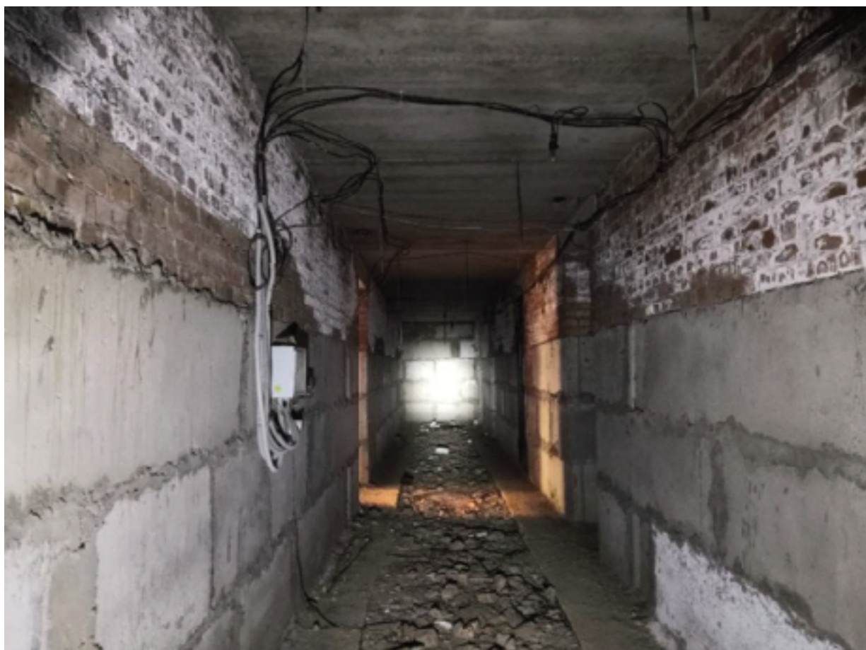
Техническое состояние подвала жилого дома 2–2
